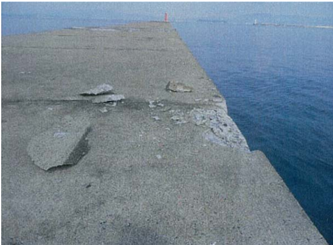
写真2 本件防波堤の損傷状況
