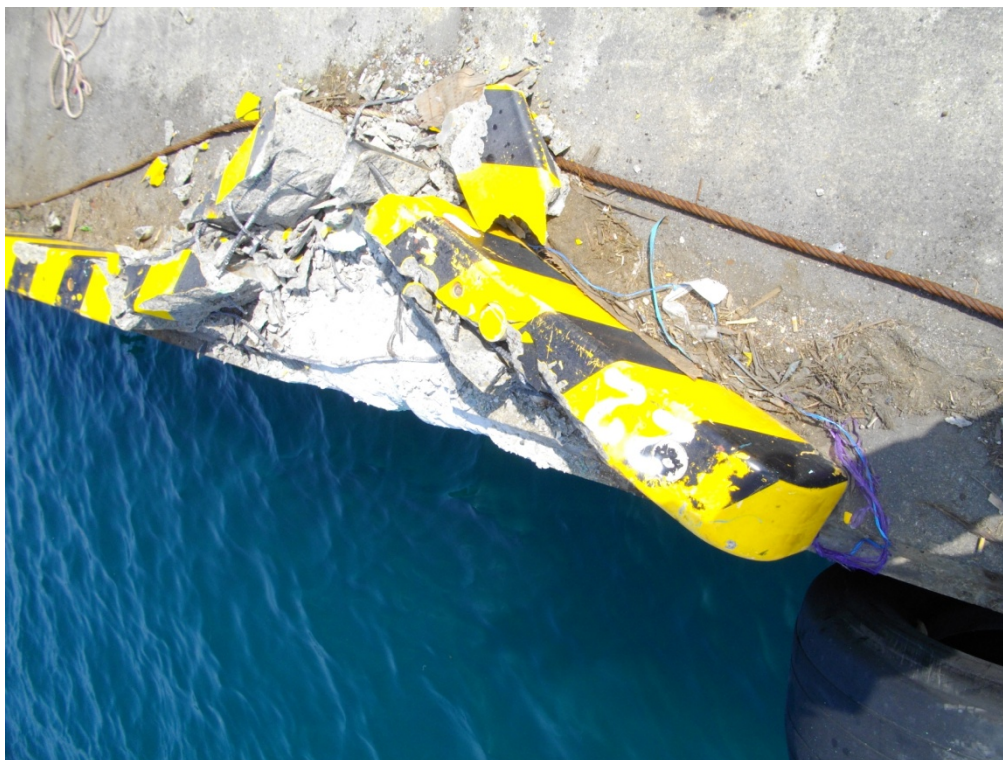
写真6 スリット柱の損傷状況
