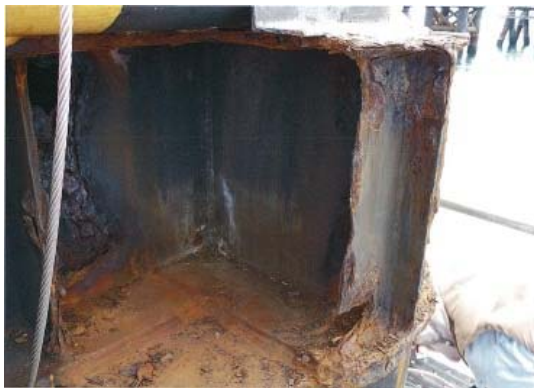
補修工事前 (平成22年6月撮影)
