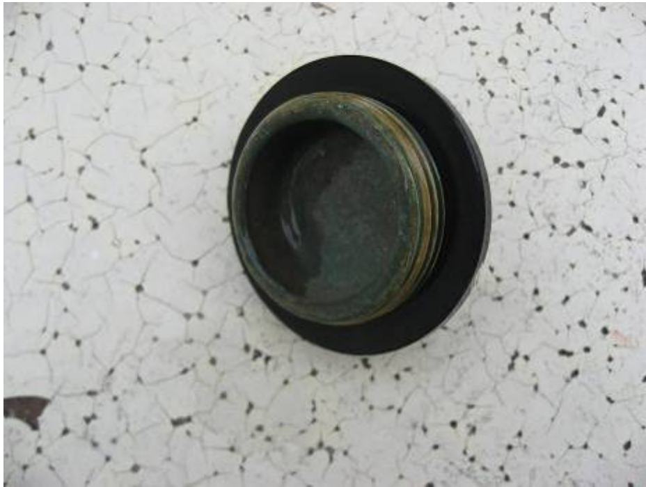
写真9 ドレンプラグ（右舷側）の状況
