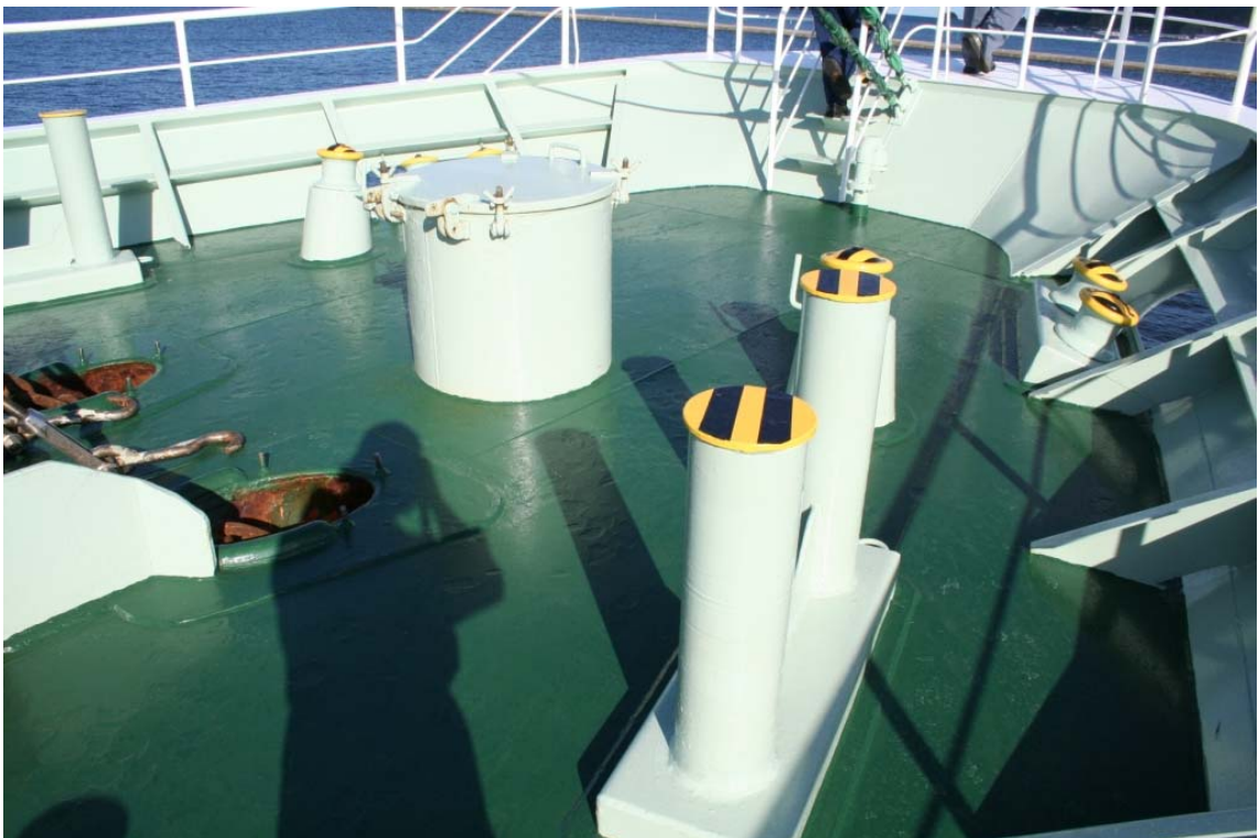
写真6 船首甲板右舷前方のボラードの状況
