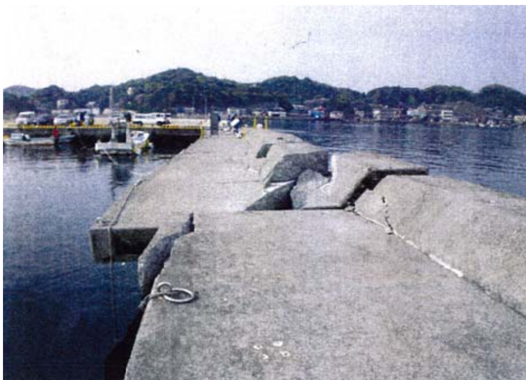
写真2 防波堤損傷部
