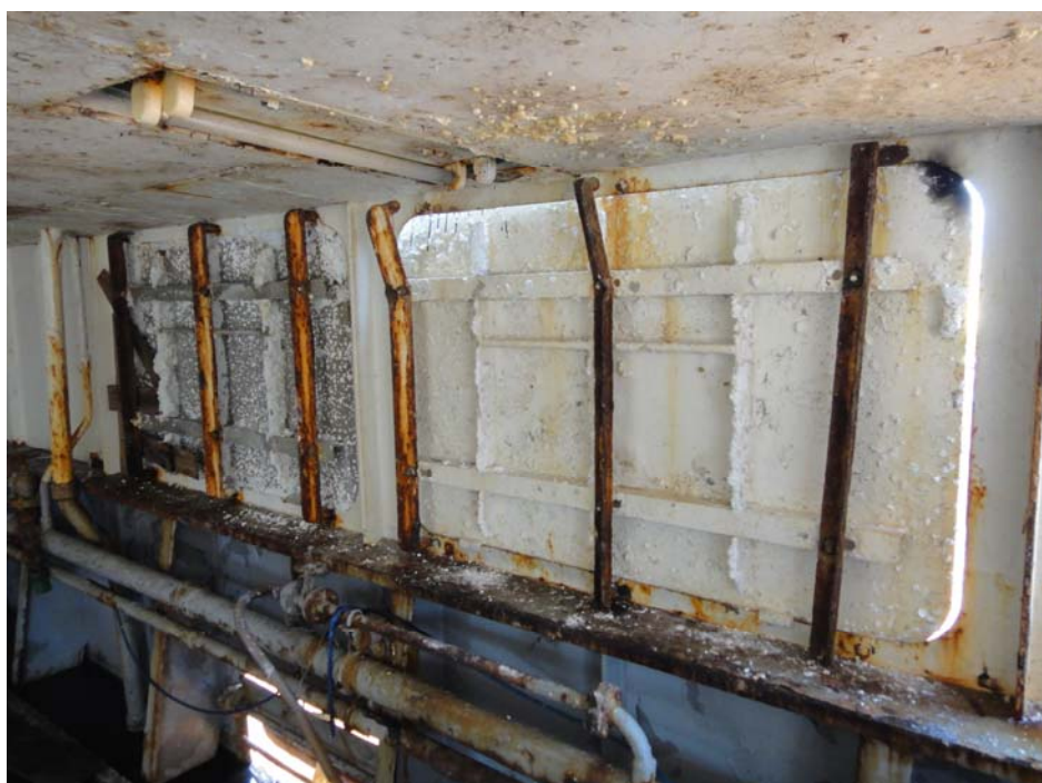
（右舷側前方より1番目及び2番目（鋼材の一部が曲損））
