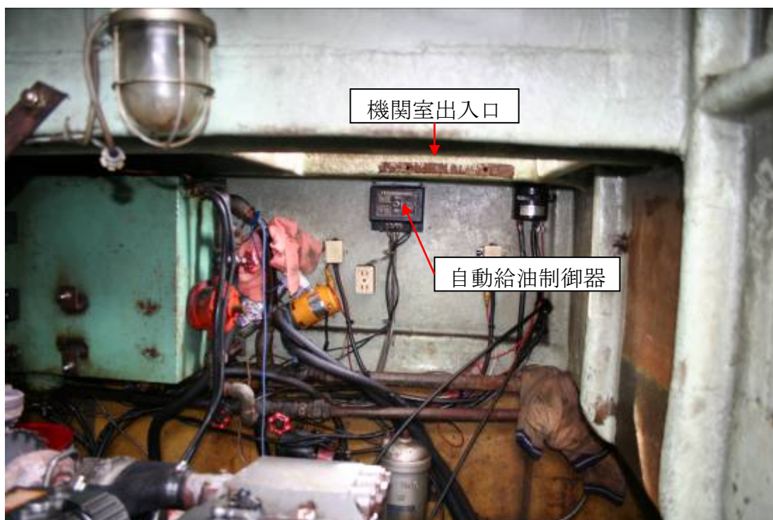
写真2 同型船の自動給油制御器の状況
