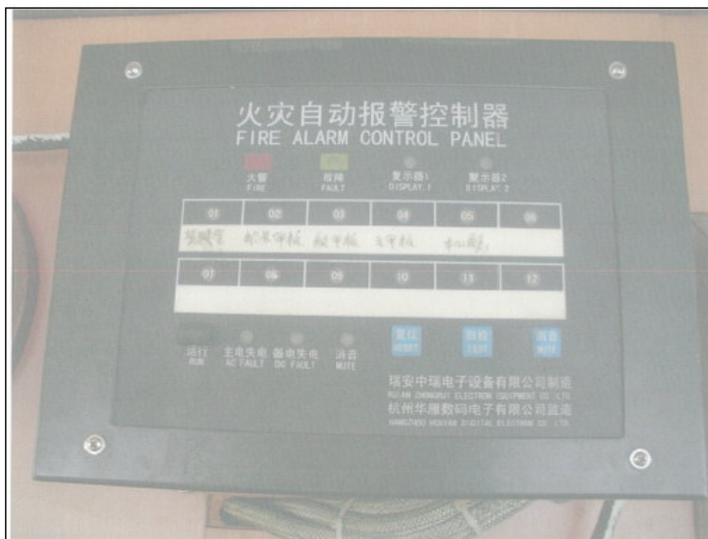
写真5 操舵室の火災警報盤
