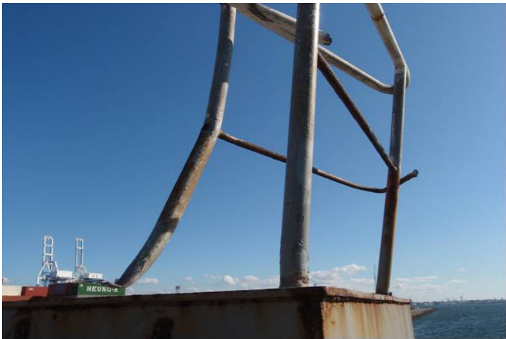
写真4 本件バージ左舷側のハンドレール損傷状況
