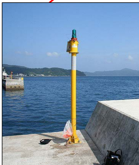
1号標識灯 (緑灯)
