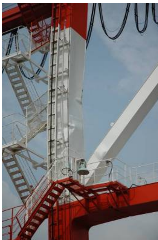
写真6 ガントリークレーンの脚部の曲損状況
