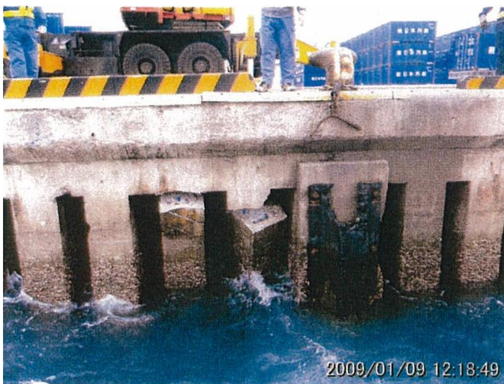
写真2 角柱部分の損傷状況
