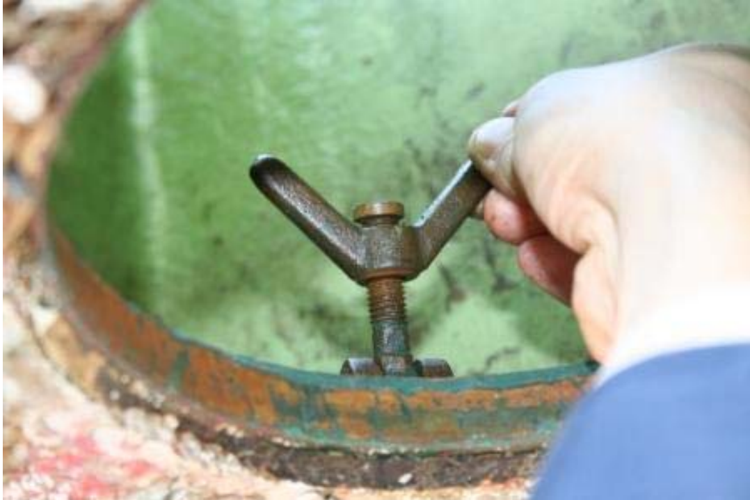
写真5 蝶ネジの状況
