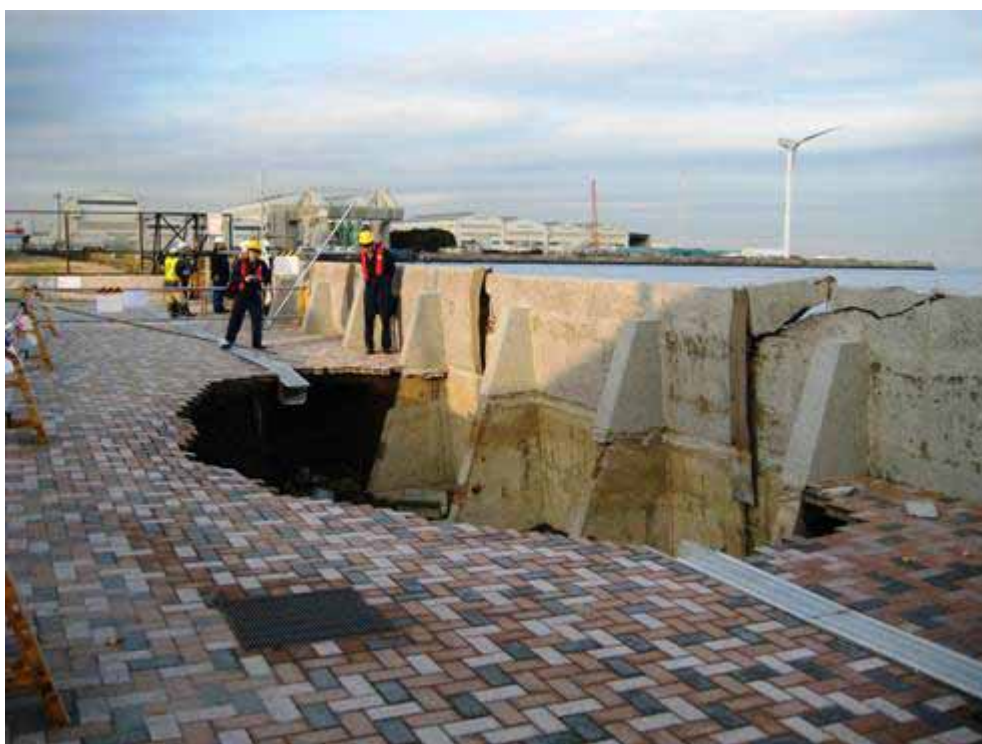
写真4 遊歩道の陥没部分
