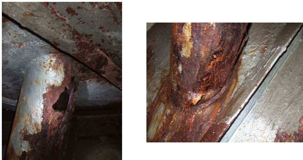
写真2 ホースパイプの破口状況
