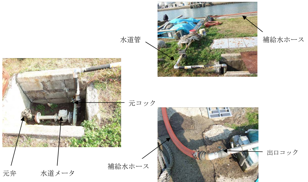
写真4 水道水の補給配管設備
