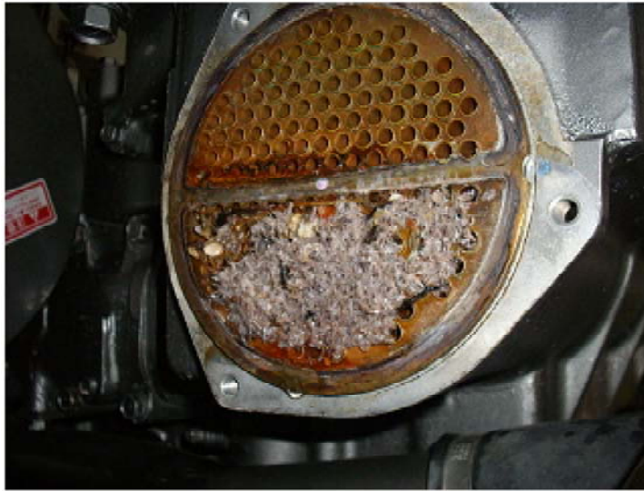
写真11 ゴム製管継手の破損状況 (本件当時)
