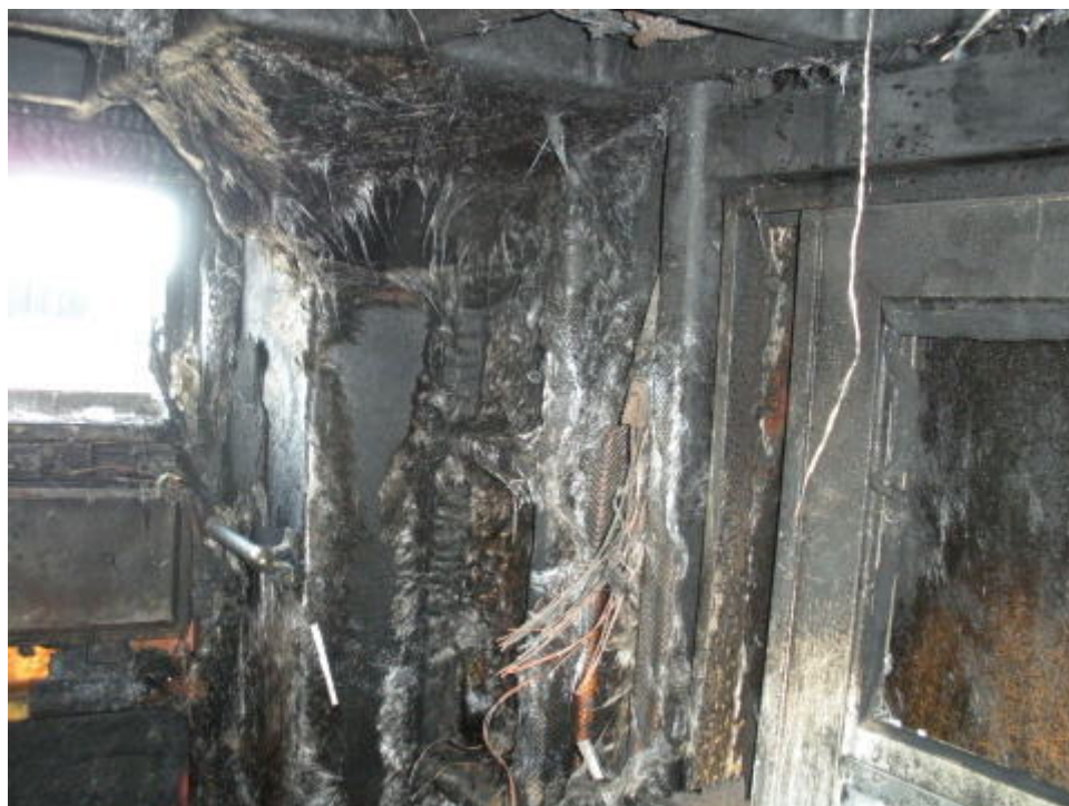
写真3 厨房の焼損状況
