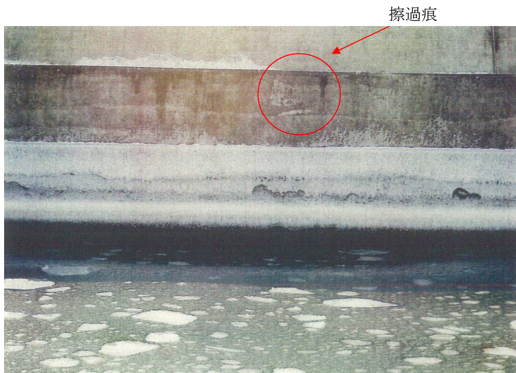
写真8 南外防波堤の損傷状況
