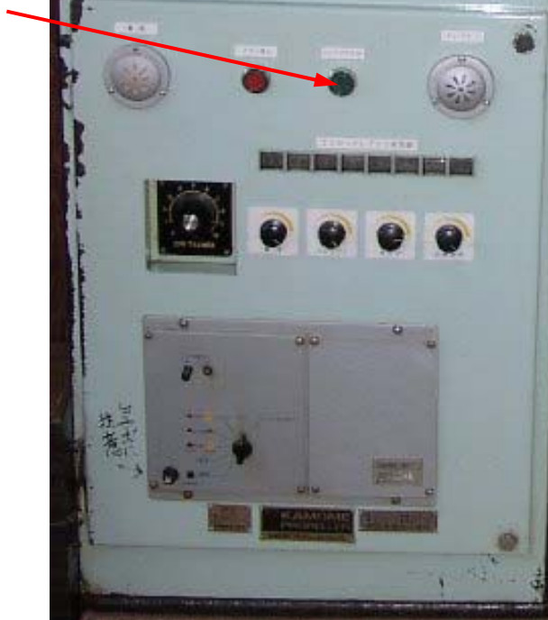
船橋 主機コンソール
