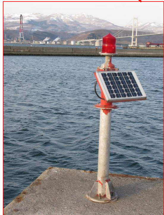
内側西防波堤標識灯（紅灯）
