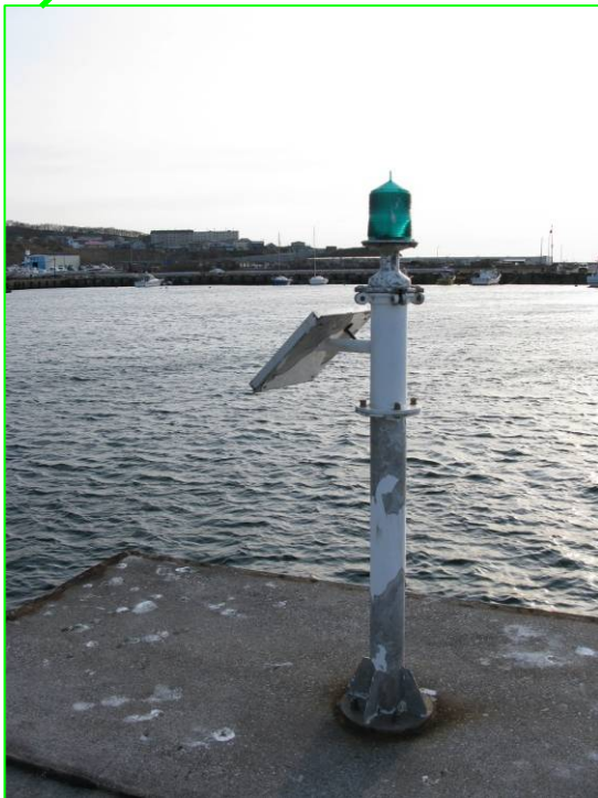
内側東防波堤標識灯（緑灯）
