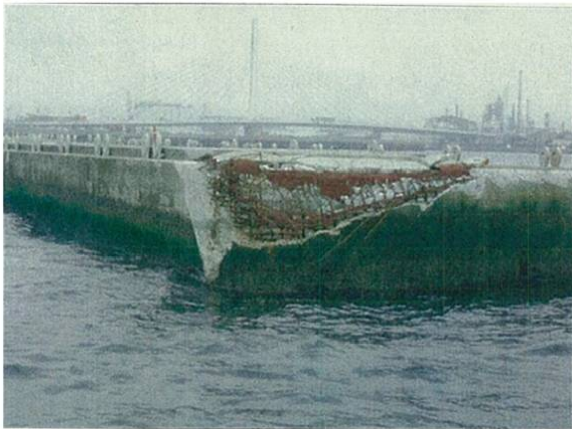
写真5 ケーソンの損傷状況
