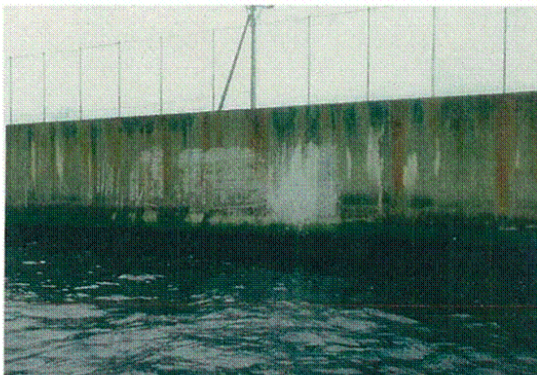
写真6 本件護岸の損傷状況
