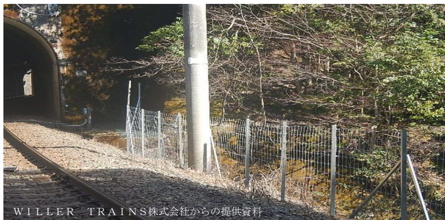
図3 宮福線に設置されている動物の侵入防止対策
