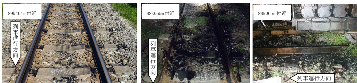
図4 軌道上の漏油の痕跡
