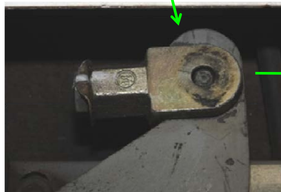
(4) 破断した接手ねじと二又及び戸吊り金具の状況（割りピンを外した状態）
