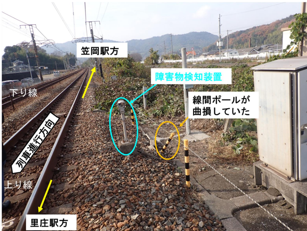
図3 鉄道施設の損傷
