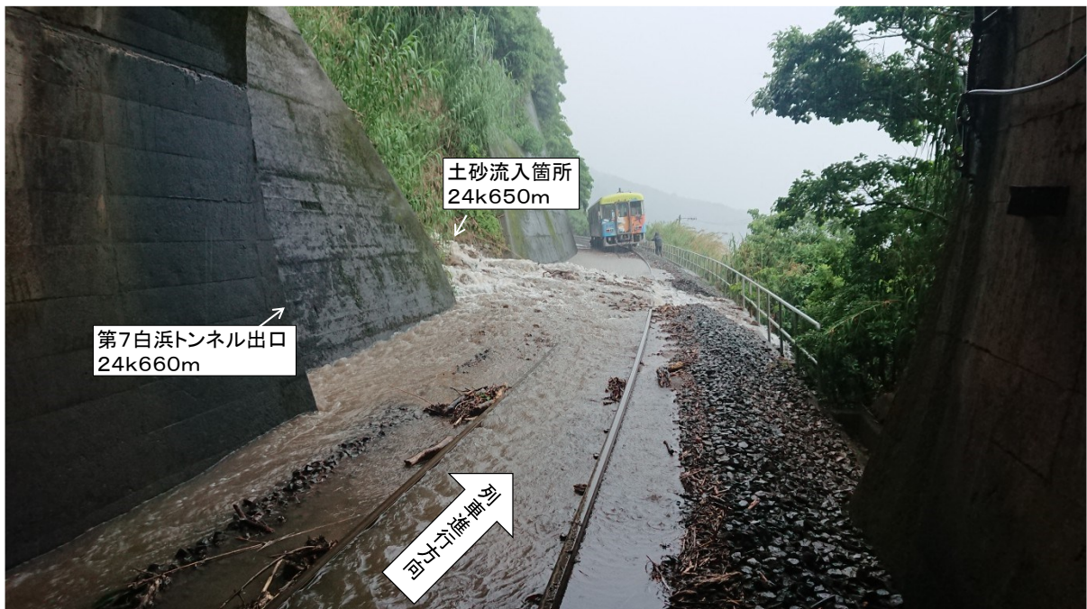
図2 土砂の流入状況（事故当日）
