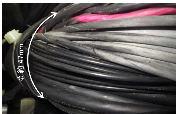
溶着位置近傍のケーブル束の状況
