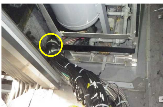
通路側から見た配線状況 (○印のケーブル束の裏側で断線)
