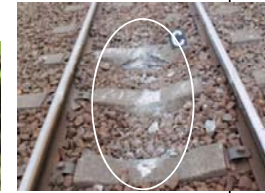
まくらぎの損傷 (69k217m付近)
