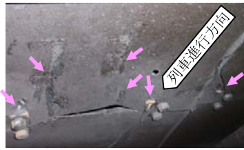
車体台枠下面の損傷
