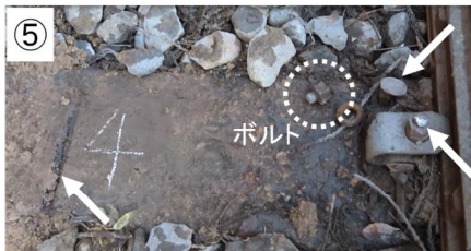
⑤ まくらぎNo.4 右レール付近軌間内側 ・締結装置のずれとボルト頭部の擦過痕 ・継目板を固定するボルトの折損 ・犬ぎの抜け上がり ・まくらぎ上の線状痕
