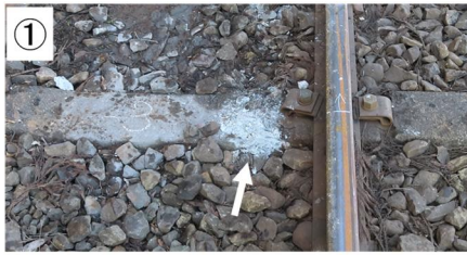
① まくらぎNo.3 右レール付近軌間内側 ・まくらぎ上の線状痕
