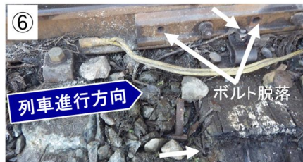
⑥ まくらぎNo.4 右レール付近軌間外側 ・締結装置のボルト頭部の擦過痕 ・まくらぎ上の線状痕 ・継目板固定用のボルトの脱落
