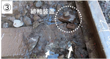
③ まくらぎNo.1 右レール付近軌間内側 ・締結装置脱落 ・まくらぎ上の線状痕
