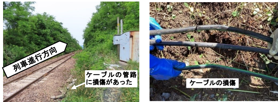
図8 ケーブルの損傷状況
