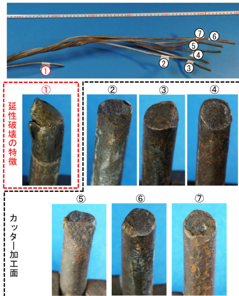
図8 支線の破断面の状況
