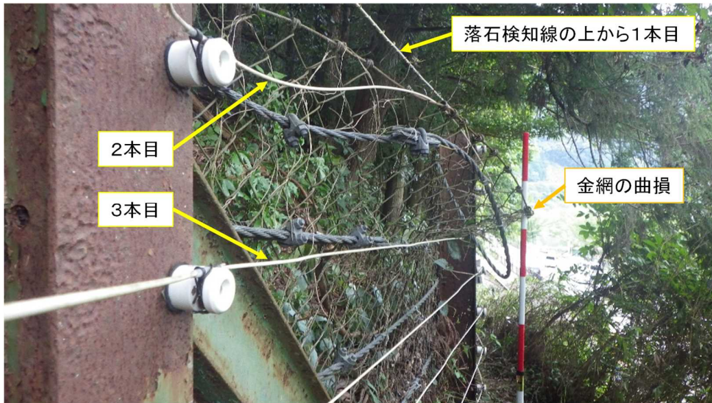
図8 落石止柵及び落石検知線の損傷状況
