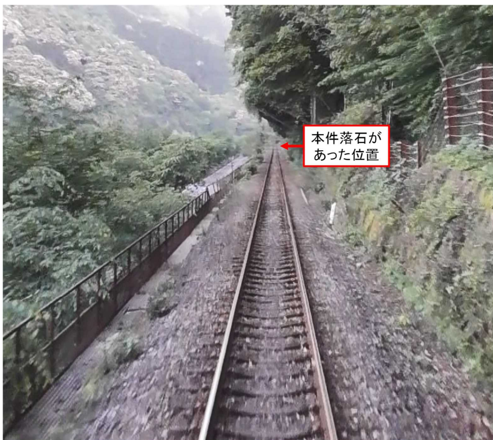
図1 本件落石があった位置の約255m手前からの前方の見通し状況
