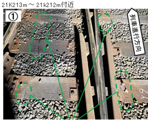
車輪フランジが軌道内を走行したと見られる痕跡
