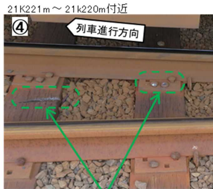
車輪フランジが走行したと見られる痕跡
