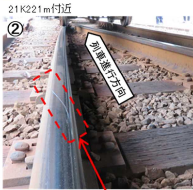
車輪フランジが乗り上げた際に生じたと思われる痕跡
