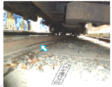
↑ 車輪による脱線防止レール右側面の擦過痕
