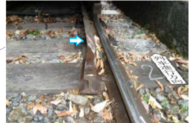
↓ 車輪によるガードレール頭部の擦過痕
