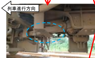
連結器胴受け曲損 (連結器が振りきった状態)
