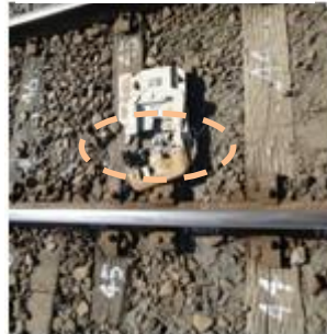
ATS地上子損傷 396k526m付近
