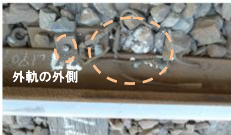
外軌側レールボンド レール固定金具損傷 396k509m付近
