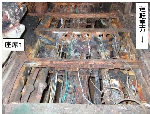
床下配線の焼損状況(床板を剥がした状態)
