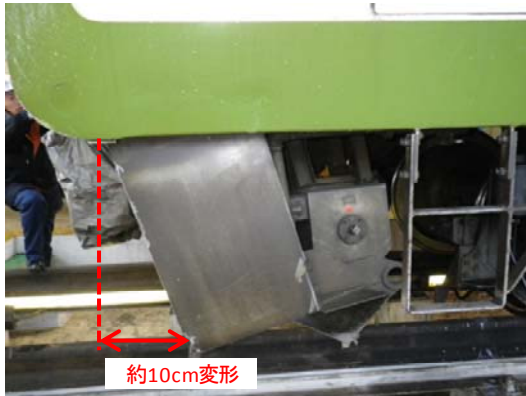
下部覆い板等損傷（左側面）
