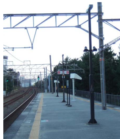
上家がないホームの状況
