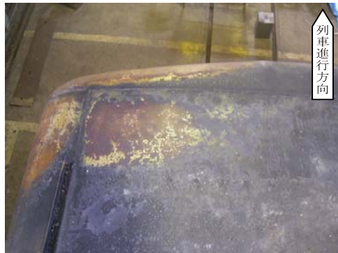
上部から見た屋根の焼損状況
