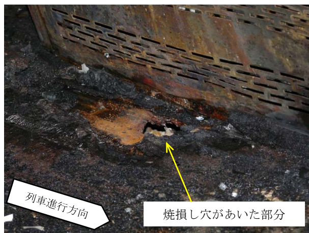
床面の損傷状況
