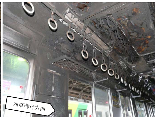
天井付近の損傷状況
