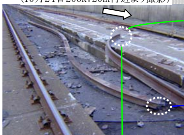
③右レールの破断箇所 (10月24日206k720m付近より撮影)
