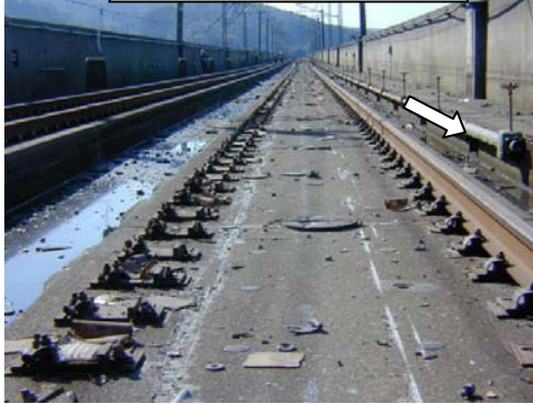
軌道スラブ上面の痕跡 (10月25日206k990m付近より撮影)
