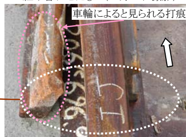
写真①の右レールと接着継目板を 組み合わせたもの(11月12日撮影)
