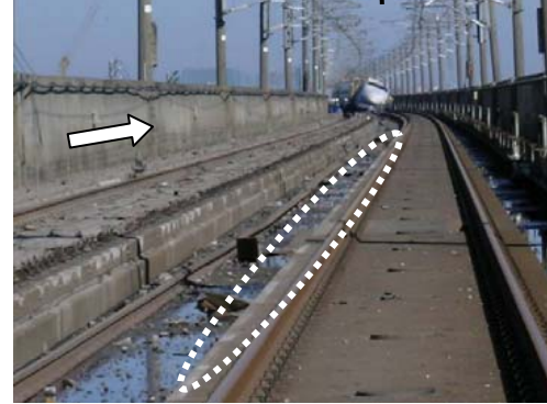
上り線の軌道スラブ上面左端部の10両目へ続く断続的な痕跡 206k828m~207k580m付近(10月25日207k090m付近より撮影)
