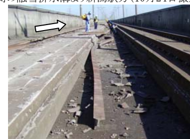
②右レール分離箇所 206k705m付近の上下線 間の融雪排水溝より新潟駅方(10月24日撮影)
