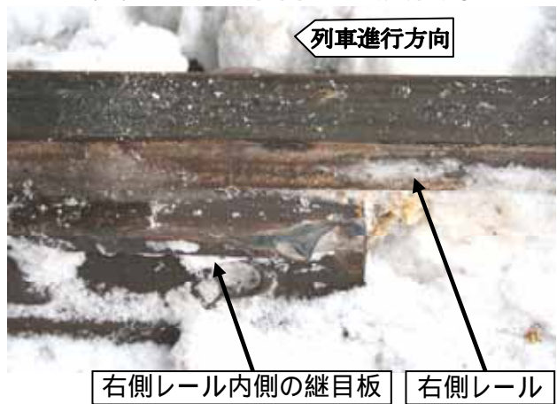
写真6 継目板の損傷状況
