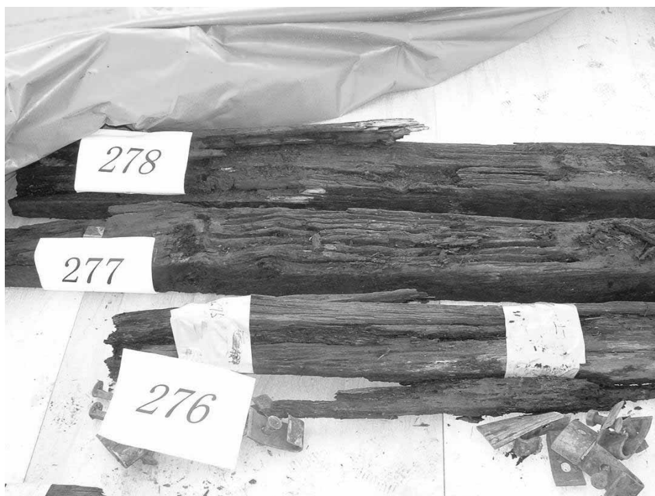
写真 1 2 腐朽が進んだまくら木
