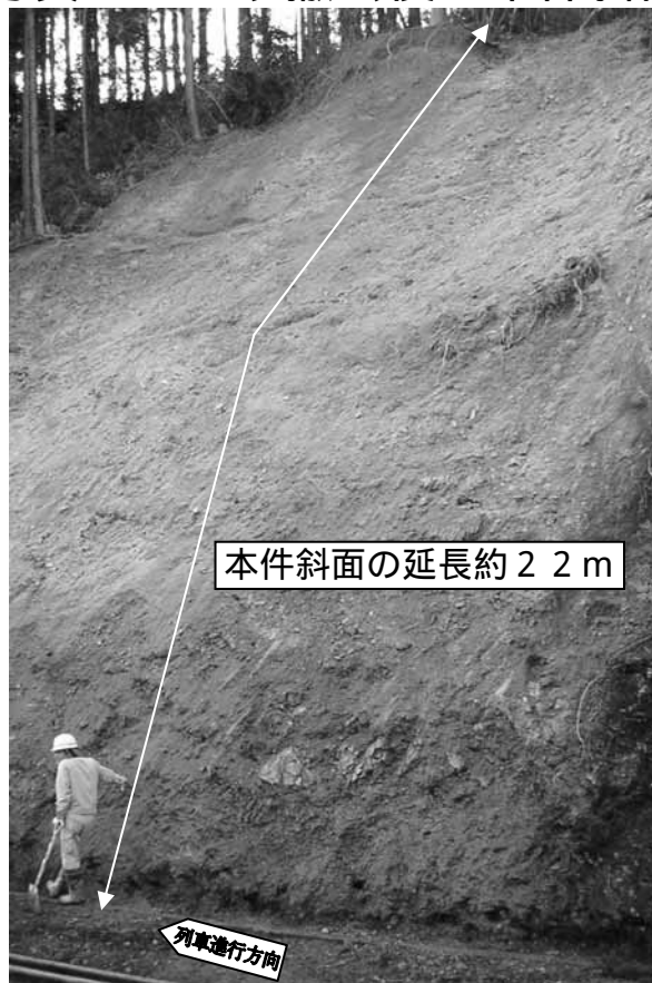
写真4 土砂撤去後の本件斜面
