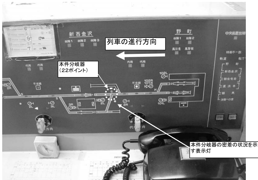
写真5 運転指令所の列車運行監視装置の状況
