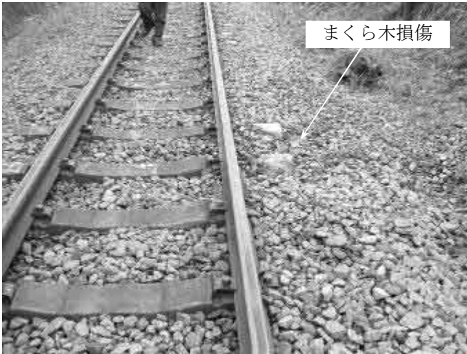
(1) 窪み箇所(94 k 153m)付近
