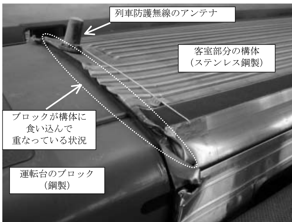
写真9 列車防護無線のアンテナ設置部の状況 (先行列車の7両目車両の屋根部分)
