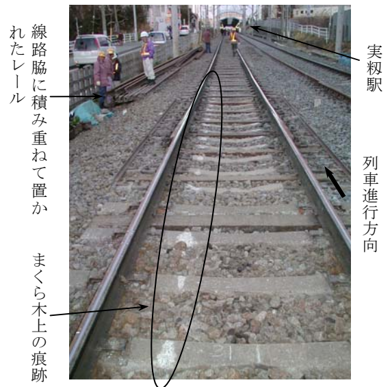
写真4 まくら木上の痕跡等 の状況
