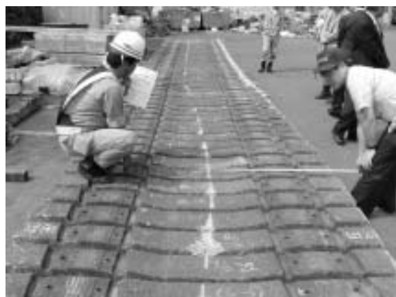
写真3 まくら木の損傷状況 (車輪フランジの痕跡)
